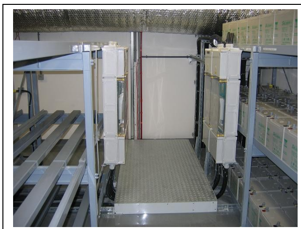
Stojak z pomieszczenia RDC w obiekcie BEYOND – ujęcie drugie
